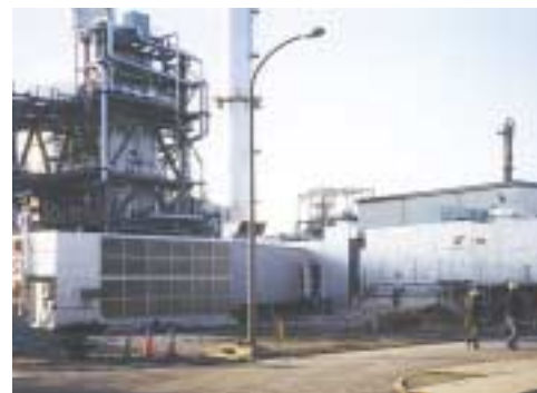
新設計のサイレンサを採用したガスタービン吸気設備 Gas turbine intake with newly designed silencer
