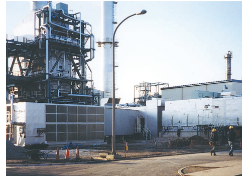
▲新設計のサイレンサを採用したガスタービン吸気設備 Gas turbine intake with newly designed silencer
