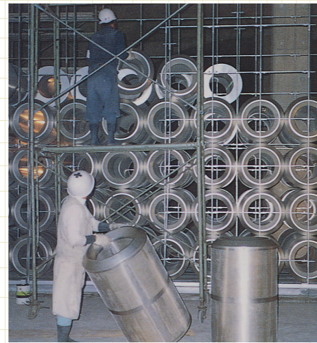
布引|トンネル地下換気所に設置される丸形エレメント
