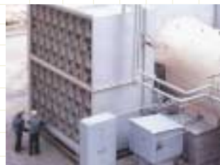
●鹿島火力発電所 軸流ファン吸込サイレンサ(初号機) 60万KW用国内初の大型軸流ファンに、丸形消音エレメントを組込んだ吸込サイレンサ。 内部騒音130dB(A)に対して、サイレンサ正面で85dB(A)を実現。
